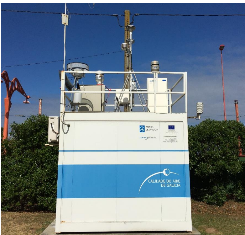
Imaxe 8. Captadores gravimétricos de PM_{10} e PM_{2,5} instalados no teito da estación Torre de Hércules realizando campañas de medición indicativa..
